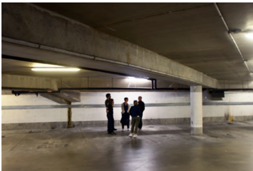
Ci-dessus : Restitution dans le parking souterrain de l'hôtel de ville
